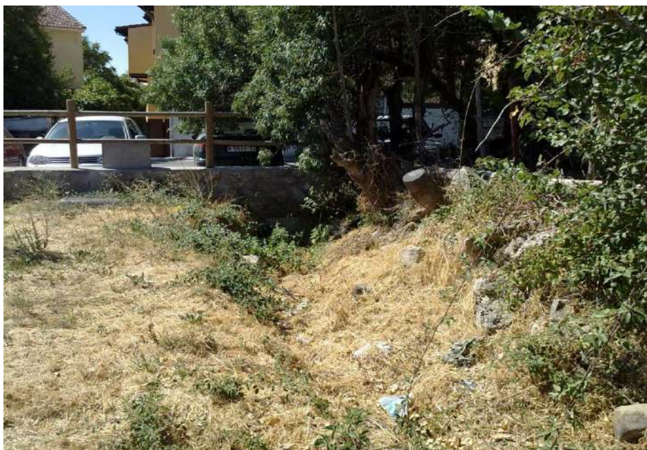
Foto 3: Lugar concreto donde la Cacera de la Fragua está cegada. (Foto realizada por la autora)
